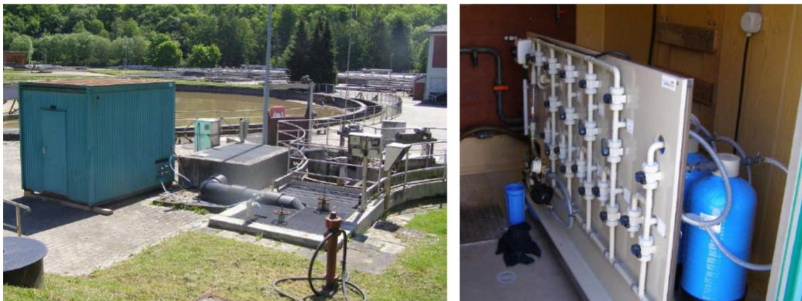
Abbildung 63: Containerstandort (links) mit 24 L Adsorbern (rechts) für das industrielle Abwasser
