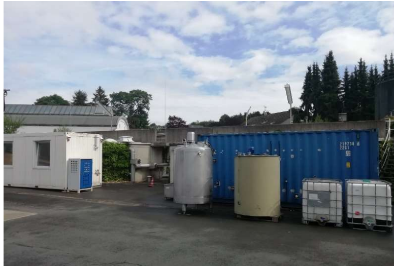
Abbildung 1: Aufstellung der Pilotanlage: Container mit Leiteinrichtung (l.) und Verfahrenscontainer (r.)
