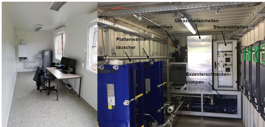
Abbildung 2: Bürocontainer mit Heißwassertherme und Prozesssteuerung (l.) und Verfahrenscontainer mit Anlagenkomponenten (r.)
