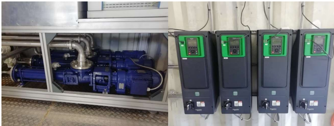
Abbildung 3: Exzenterschneckenpumpen (l.) und Frequenzumrichter für Pumpen u. Rührwerk (r.)
