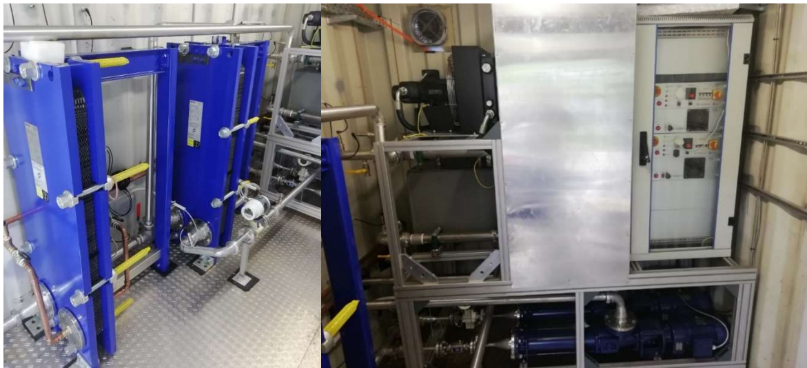
Abbildung 4: Plattenwärmetauscher (l.) und schallisolierte Ultraschalleinheit (r.)
